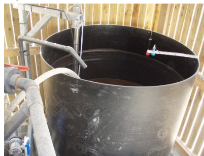
Photo : La cuve de mélange est équipée d'une sonde de niveau permettant de réguler les flux d'effluent.
