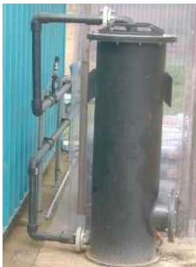
LE FILTRE À CHARBON PROTÈGE LE MOTEUR ET PURIFIE LE MÉTHANE PRODUIT AU NIVEAU DU DIGESTEUR.
