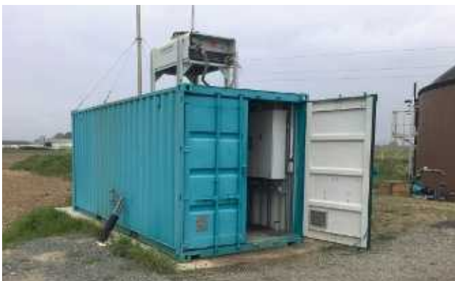
UN CONTENEUR ABRITE LE MOTEUR ET LES ARMOIRES ÉLECTRIQUES. LE DISPOSITIF EST PEU BRUYANT GRÂCE À LA FIXATION DU MOTEUR SUR DES SILENTBLOCS FACILITANT L'ABSORPTION DES VIBRATIONS.
